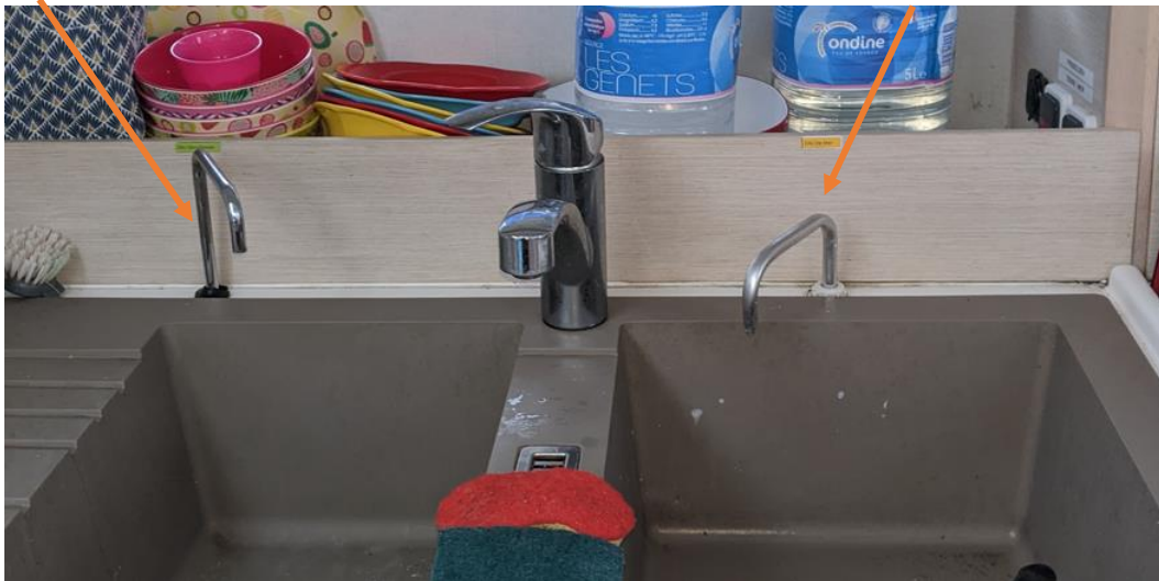
Robinet Eau de mer (existant) . Et sortie saumure du dessalinisateur
